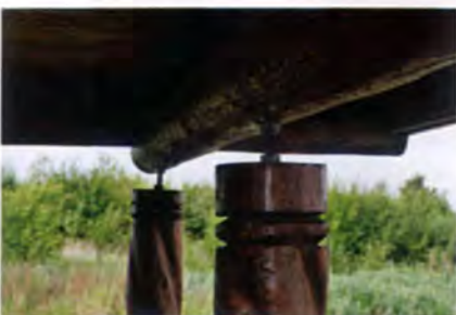
Компенсаторы усадки на деревянных колоннах-опорах.
