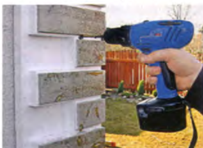
Сквозь панель дрелью в основании стены просверливают отверстия под пластиковые дюбели, в которые затем вкручивают шурупы.
