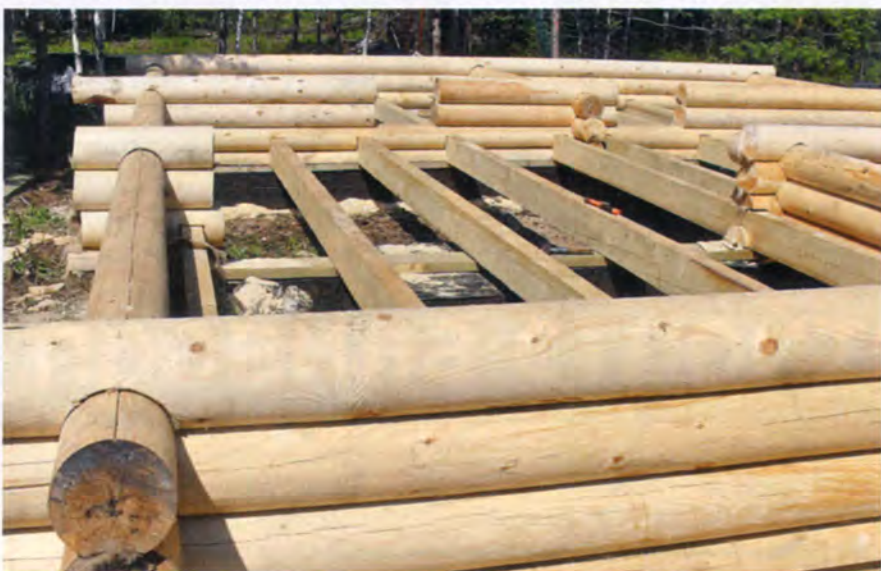
Промышленно изготовленные соединения оцилиндрованных брёвен (простейшая чаша в полдерева) лишены внутренних замковых элементов и защищены от продувания лишь теплоизоляционными материалами.
