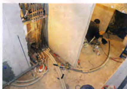
Горячее и холодное водоснабжение выполнено с использованием труб Rehau.
